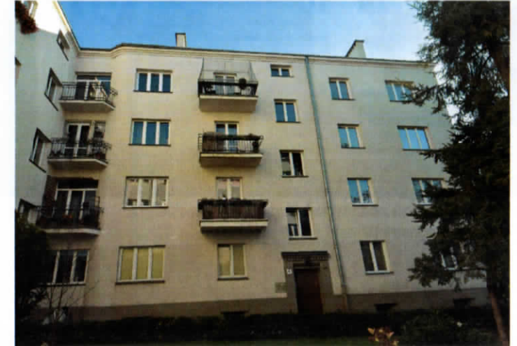
Fot. 3. Elewacja zachodnia z balkonami w 1. i 3. osi - skrzydło z klatką schodową III (analogiczna w klatkach V i VII)
